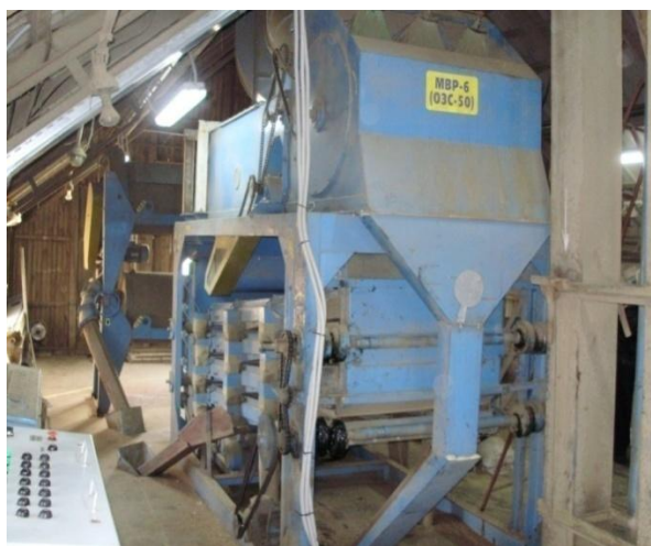
Рис. 2. Отделение первичной очистки с зерноочистительной машиной ОЗС-50 и триерным блоком БТЦ
